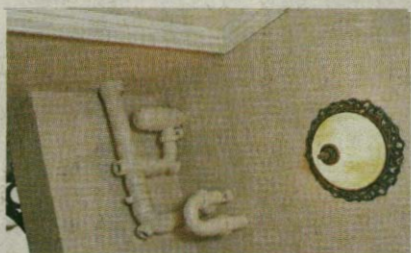
▲大門旁水管外露，影響外觀。
